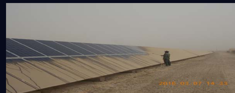
河南地面电站 Utility-scale power plants in Henan Province
