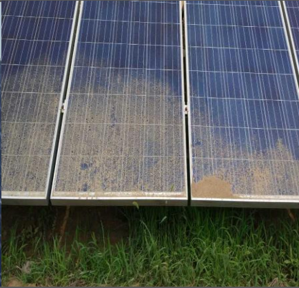
泥土遮挡 (Surface soiling)
